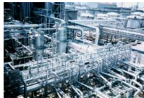
プラント内ステンレス配管
