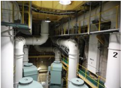
船内に配管された 内面ポリエチレンライニング鋼管
