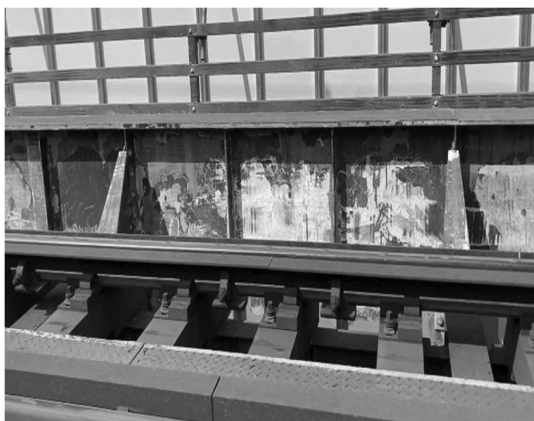
図3 鉄道橋の塗膜剥離事例
